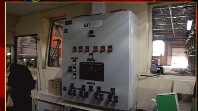
Шкаф управления освещением и ДГУ
